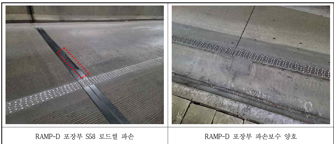
【사진 3.3.30】 포장부 손상현황
