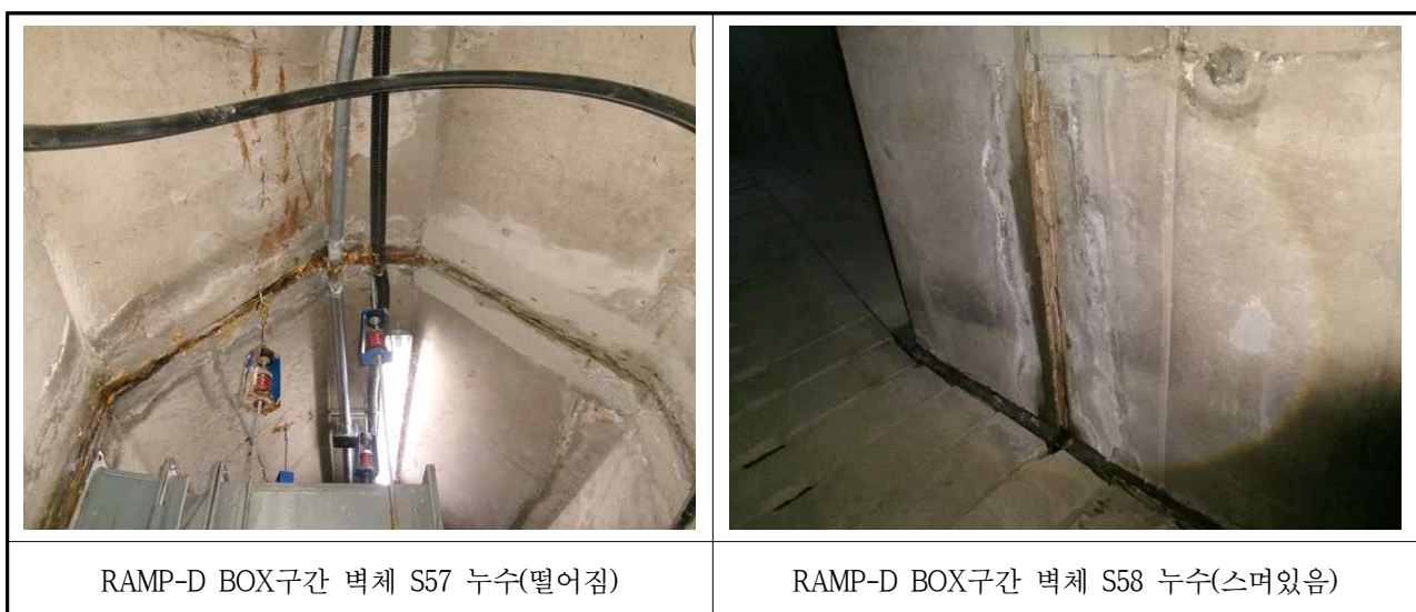
【사진 3.3.22】 BOX구간 벽체 손상현황
