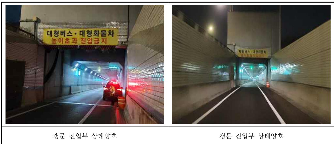
【사진 3.3.36】갯문 손상현황
