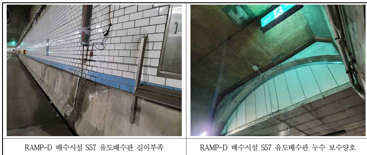
【사진 3.3.34】 배수시설 손상현황
